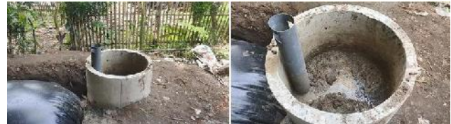
Gambar 4. Bak penampungan slurry dan saluran inlet biogas
