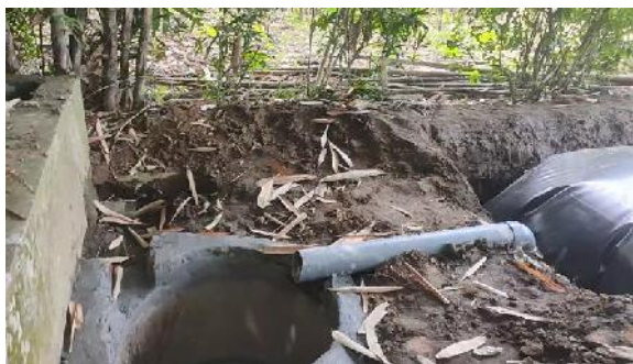
Gambar 6. Bak penampungan slurry
