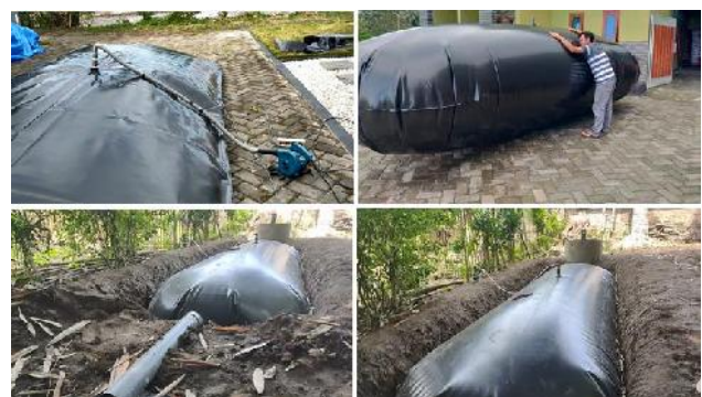
Gambar 5. Instalasi digester balon pada mitra
