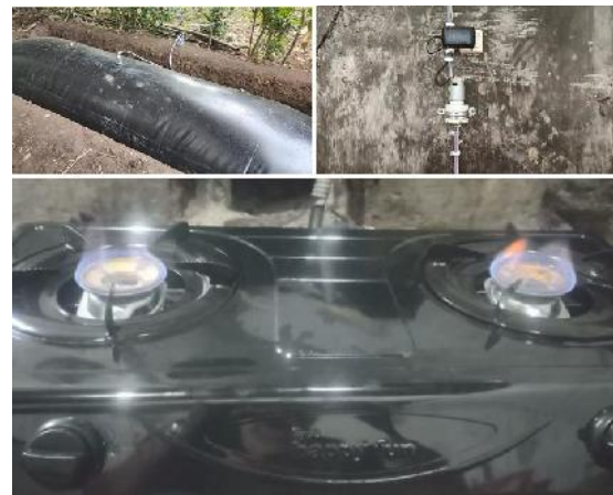
Gambar 7. Instalasi saluran biogas pada mitra
