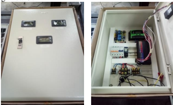
Gambar 9. Panel Auto-Switch Mini PLTS Off-Grid
