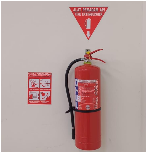
Gambar 4. Pemasangan APAR sesuai peraturan
