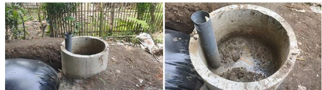
Gambar 4. Bak penampungan slurry dan saluran inlet biogas
