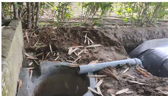
Gambar 6. Bak penampungan slurry
